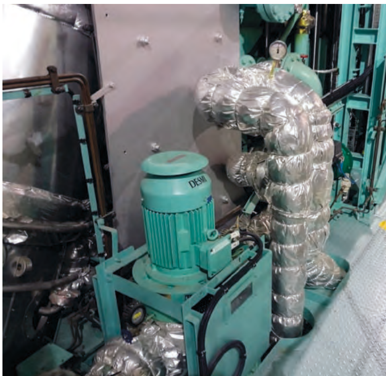
Rys. 71. Pompa cyrkulacyjna układu LDCL / LDCL cooling water system circulation pump
