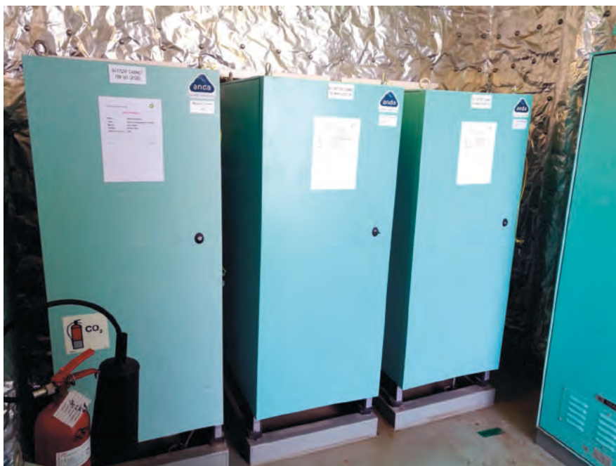
Rys. 90. Stacja akumulatorów systemu UPS / UPS batteries station
