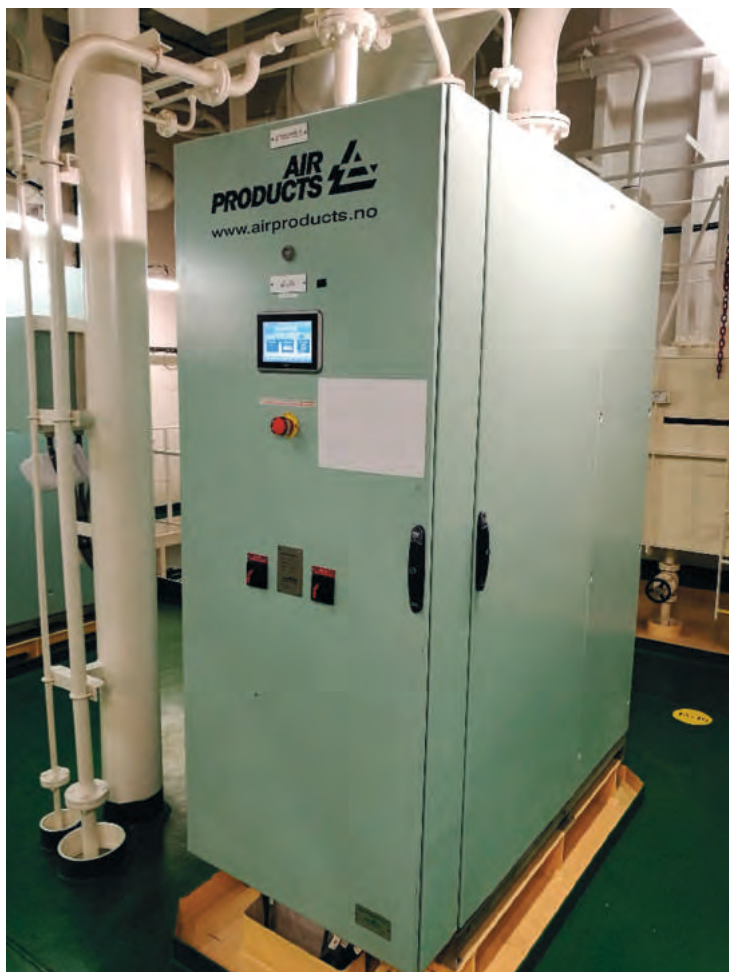
Rys. 81. Urządzenie wytwarzające azot w formie gazowej / N2 generator
