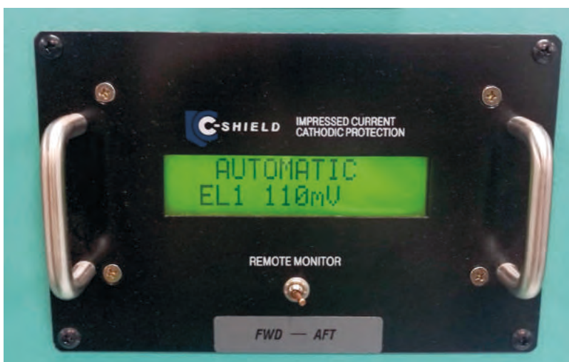
Rys. 66. Panel kontrolny systemu elektrochemicznej ochrony katodowej kadłuba statku / ICCP control panel
