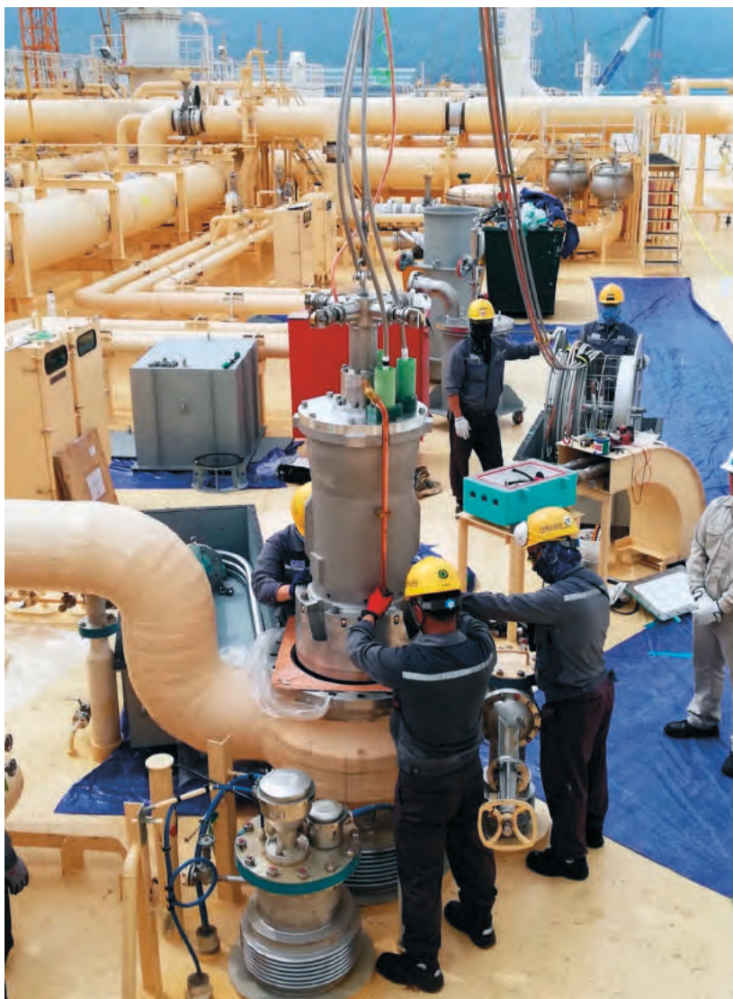
Rys. 27. Awaryjna pompa ładunkowa / emergency cargo pump
