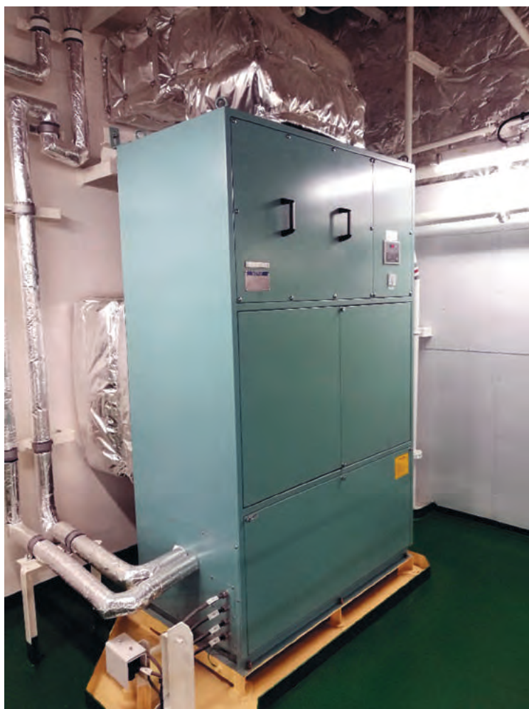
Rys. 36. Konwektor klimatyzacji pomieszczenia rozdzielni niskiego napięcia / fan coil unit
