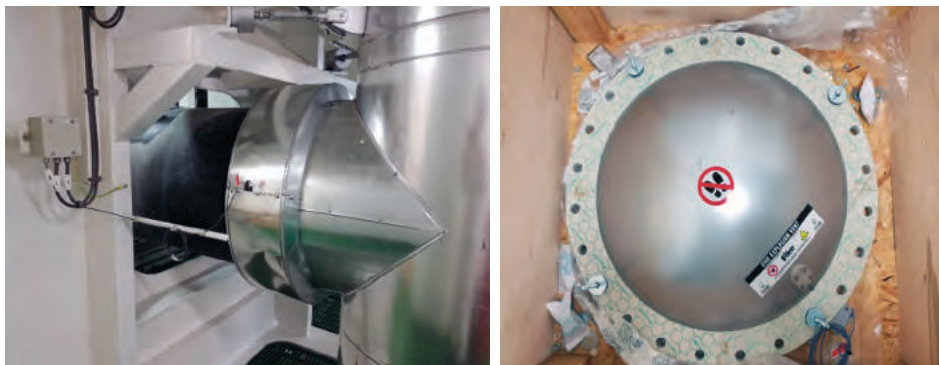
Rys. 86. Przykład bezpiecznika membranowego, zainstalowanego w przewodzie wylotowym spalin silnika pomocniczego / rupture disc
