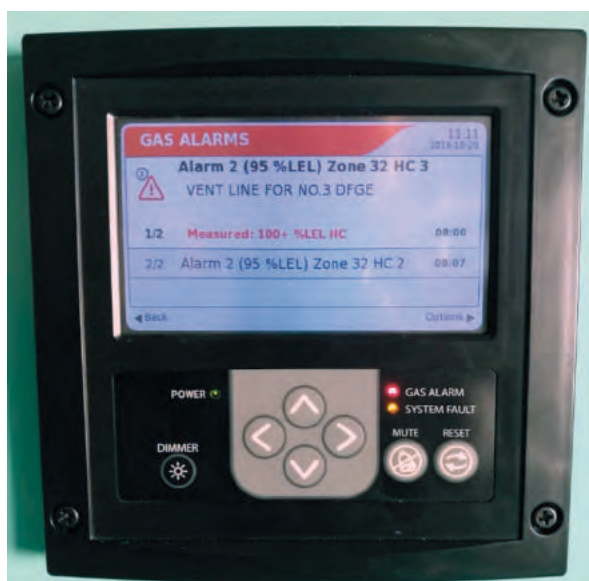
Rys. 46. Panel alarmowy systemu wykrywania gazu / gas detection system alarm panel
