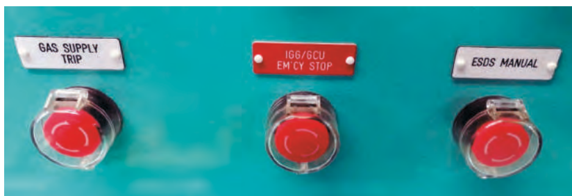
Rys. 29. Przykład przycisków ESD znajdujących się na konsoli w pokładowej centrali sterująco-kontrolnej / ESD pushbuttons on CCR console
