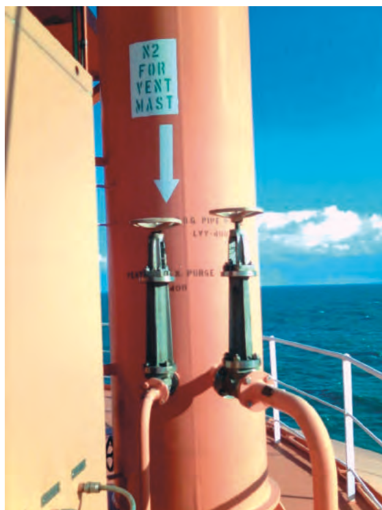
Rys. 94. Przewód do przedmuchiwania azotem masztu odpowietrzającego / vent mast nitrogen purging line
