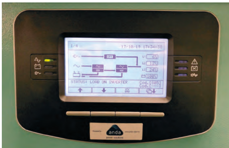
Rys. 91. Panel sterujący ładowaniem akumulatorów systemu UPS / UPS control panel
