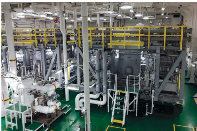
Rys. 55. Widok z górnego podestu kompresorowni na dwie wysokociśnieniowe sprężarki gazu / two high pressure compressor
