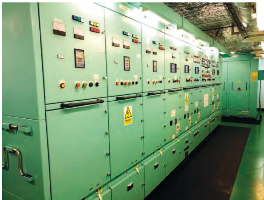
Rys. 57. Główna rozdzielnia wysokiego napięcia / high voltage switch board
