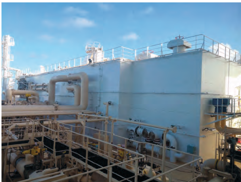
Rys. 14. Pomieszczenie sprężarek ładunkowych / compressor room
