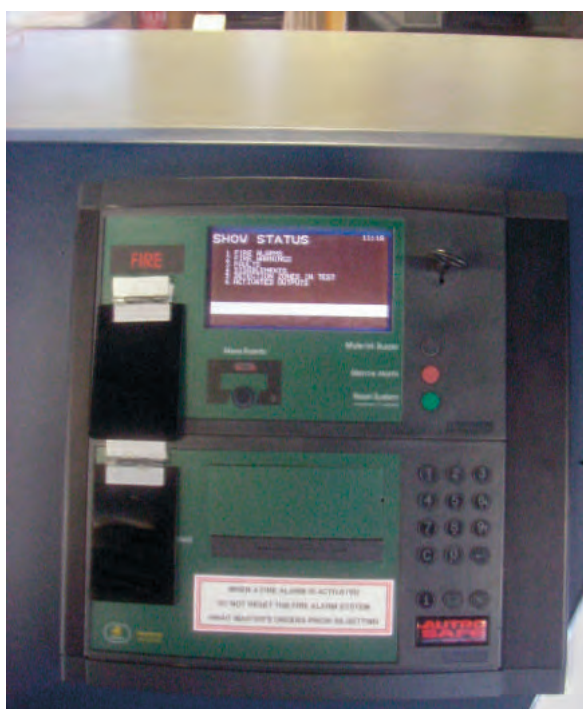
Rys. 37. Panel alarmów pożarowych / fire alarm panel
