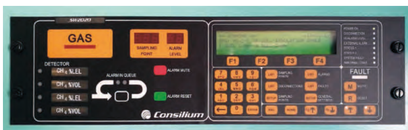
Rys. 50. Panel sterujący systemem pobierania próbek gazu / gas sampling system panel
