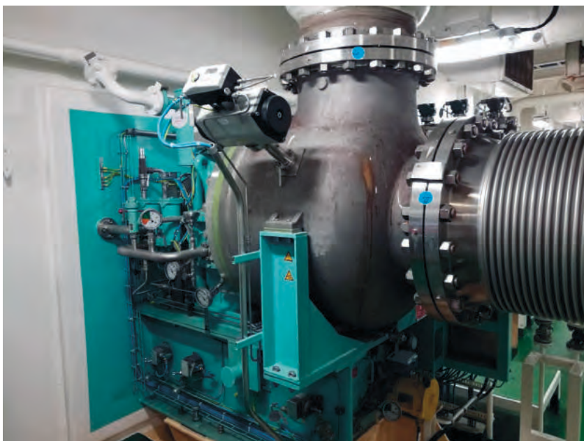
Rys. 53. Wysoko wytężona sprężarka kontrolująca ciśnienie w zbiornikach podczas załadunku / HD compressor
