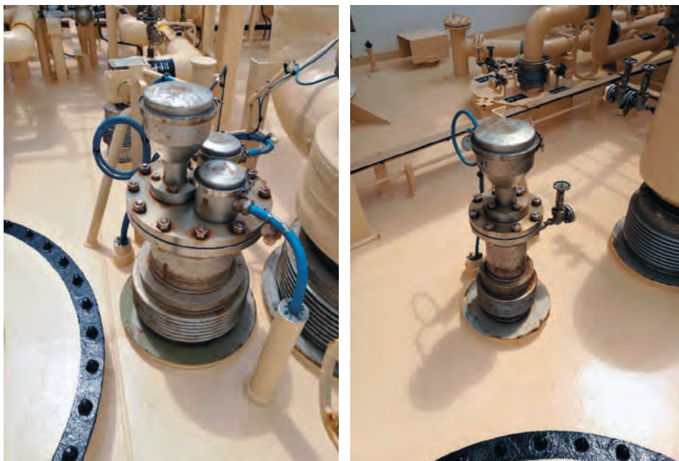
Rys. 18. Urządzenia pomiarowe systemu nadzoru ładunku / radar tank gauge
