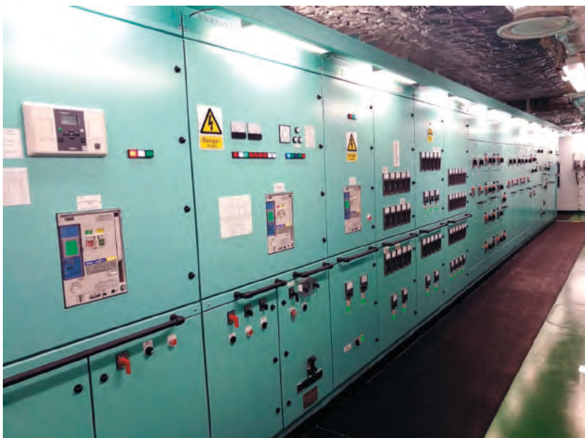
Rys. 76. Główna rozdzielnia niskiego napięcia / low voltage switch board
