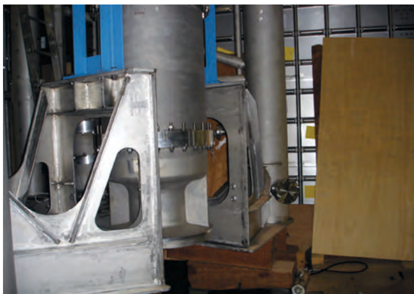
Rys. 11. Pompa ładunkowa / cargo pump. Zdjęcie wykonano w trakcie montażu w zbiorniku ładunkowym na stoczni
