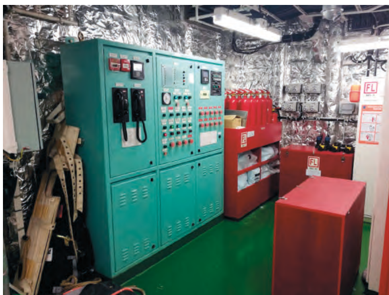
Rys. 38. Stacja przeciwpożarowa / fire control center
