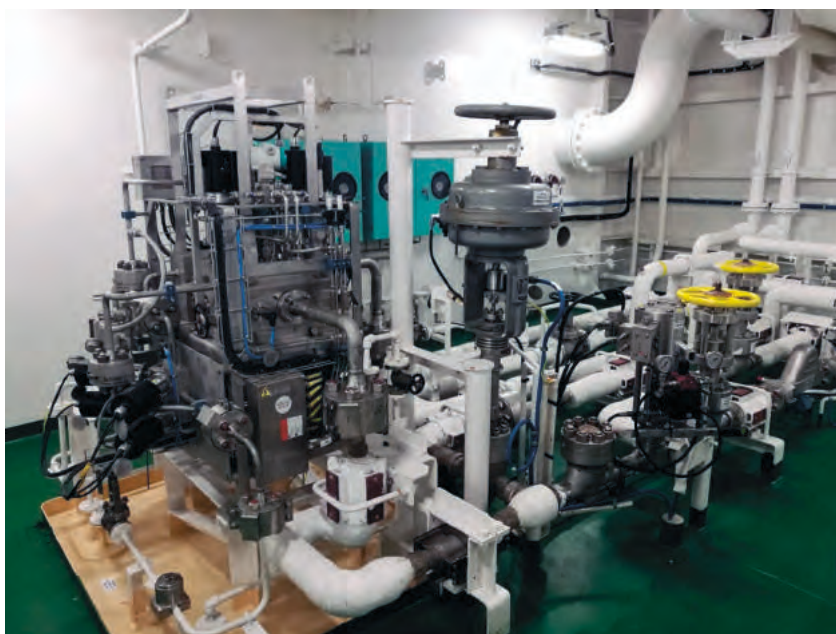
Rys. 51. Urządzenie kontrolujące przepływ gazu do silników głównych MEGI / gas valve train
