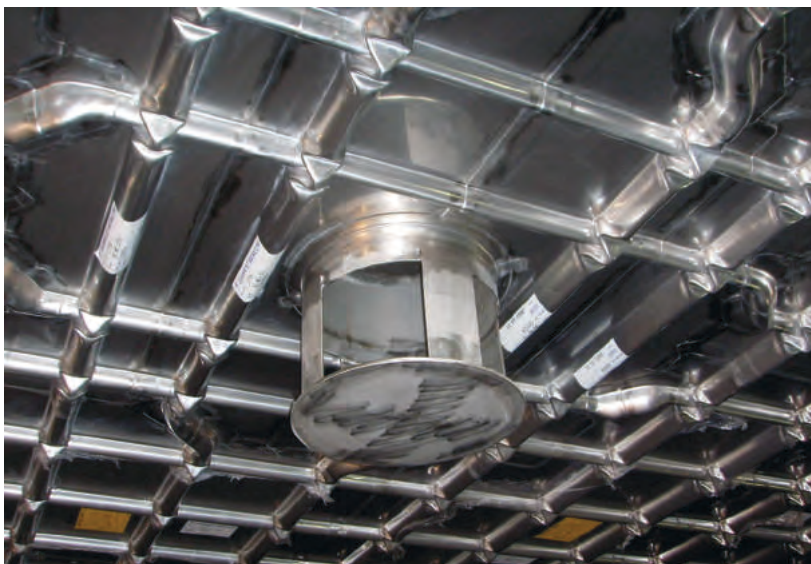
Rys. 48. Kopuła gazu zbiornika ładunkowego widziana od strony zbiornika / gas dome view from cargo tank
