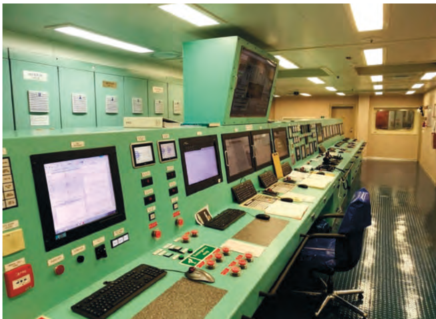
Rys. 30. Maszynowa centrala manewrowo-kontrolna / engine control room
