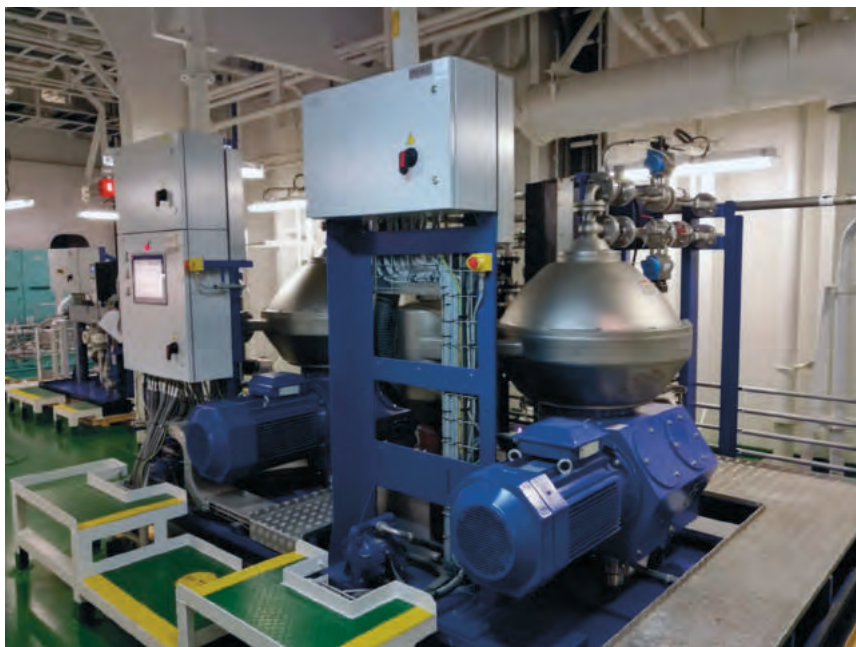
Rys. 96. Zespół separatorów oczyszczający wodę w procesie EGR / water treatment unit
