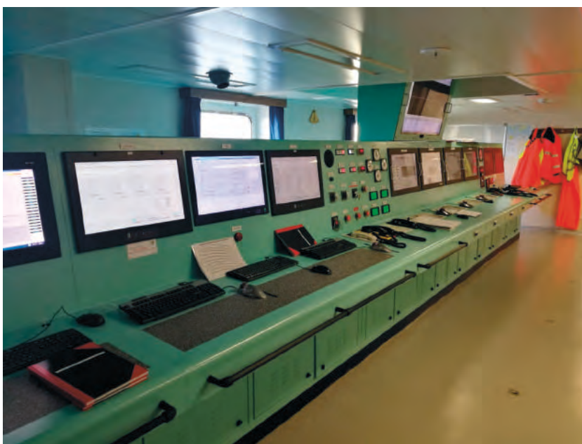
Rys. 10. Pokładowa centrala sterująco-kontrolna / cargo control room
