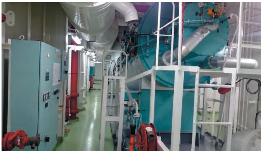
Rys. 61. Wytwornica gazu obojętnego / inert gas generator
