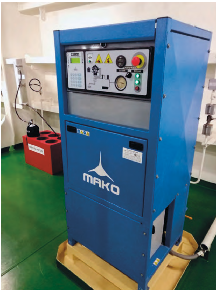
Rys. 8. Sprężarka powietrza butli aparatów oddechowych / BA compressor
