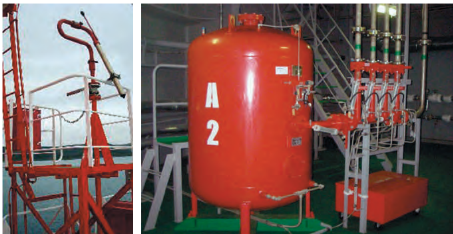
Rys. 22. Proszkowy system gaśniczy, z lewej prądownica, z prawej zbiornik na suchy proszek / dry powder fire fighting system, left – dry powder monitor, right – dry powder tank
